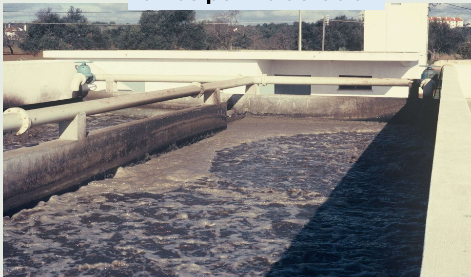
Estabilização de lamas por via aeróbia
